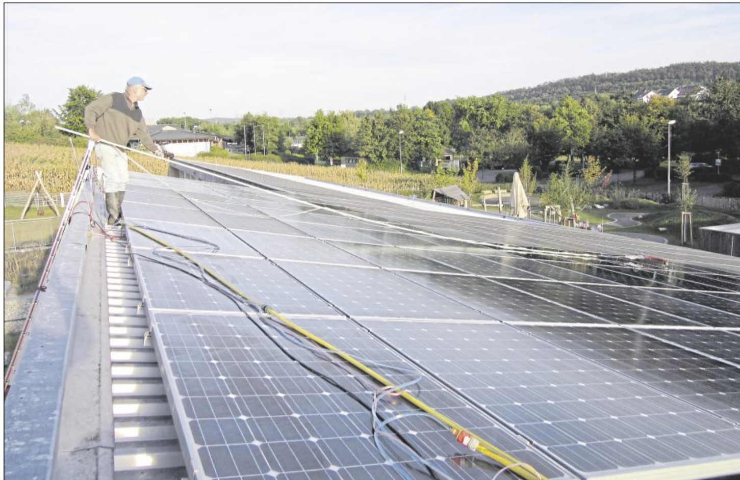
Der Härtestest für Ernst Dilgers Eigenbau: Die 550 Quadratmeter große Anlage auf dem Dach des Kinderhauses Badstraße.
